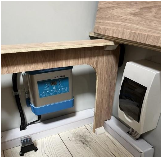
Ilustracja nr 3-zasilacz wraz ze skrzynką bezpiecznikową
