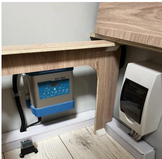
Ilustracja nr 3-zasilacz wraz ze skrzynką bezpiecznikową
