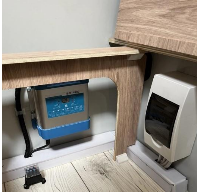
Ilustracja nr 3-zasilacz wraz ze skrzynką bezpiecznikową
