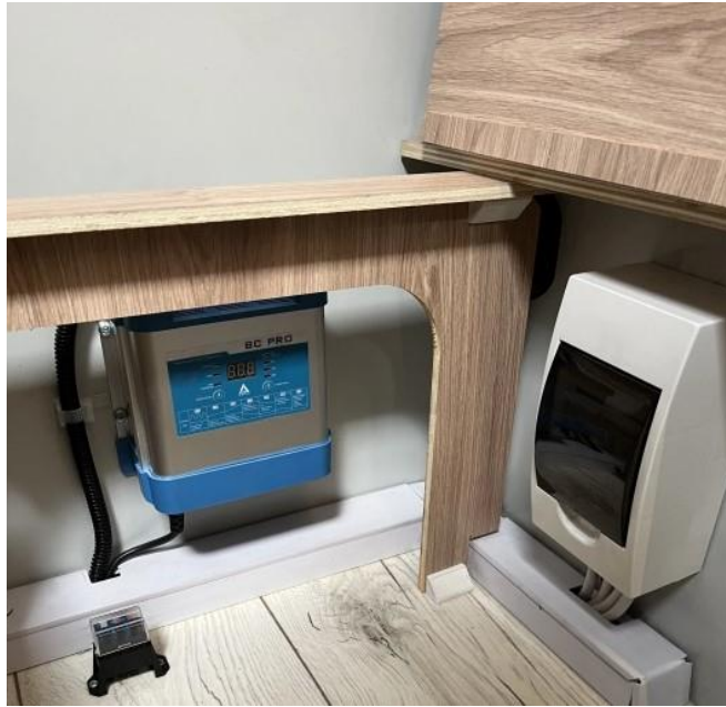
Ilustracja nr 3-zasilacz wraz ze skrzynką bezpiecznikową
