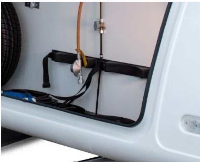
Ilustracja nr 5- miejsce na butlę gazową wraz z pasami mocującymi, wężem elastycznym i reduktorem
