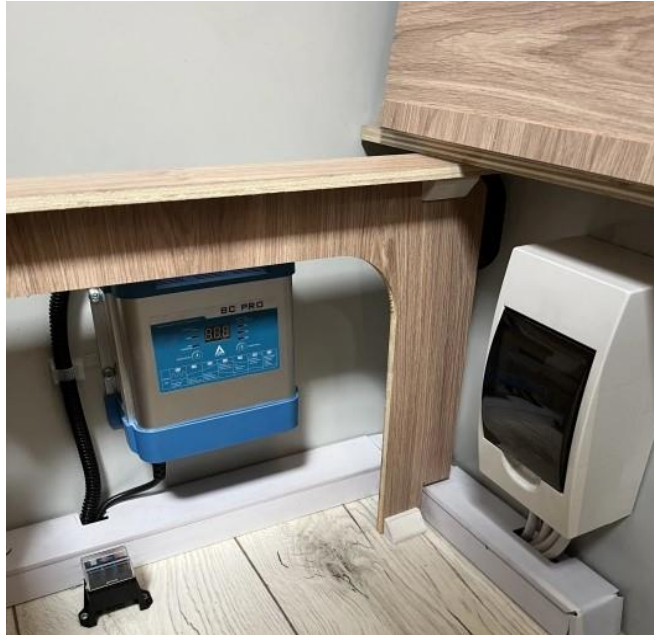
Ilustracja nr 3-zasilacz wraz ze skrzynką bezpiecznikową
